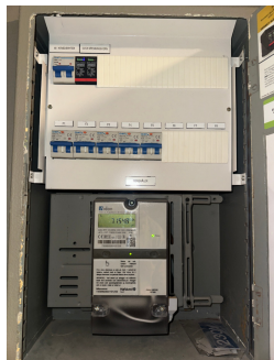
Sikringskap med automatsikringer.
