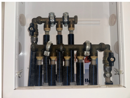
Samleskap med rørkurser og stoppekraner
