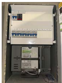
Sikringsskap med automatsikringer.
