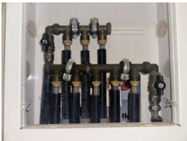
Samleskap med rørkurser og stoppekraner
