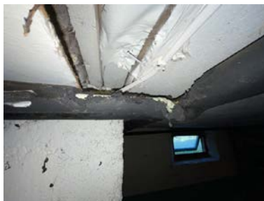
Gnagesår etter skadedyr.
