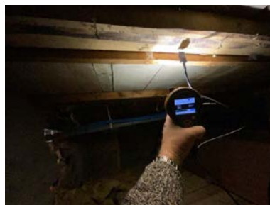
Det ble målt med pigg i stubbloft, og det ble ikke indikert noen unormale høye fuktverdier på befaringsstidspunktet.
