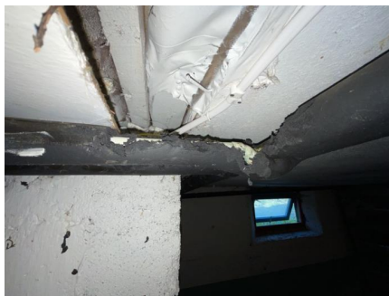
Gnagesår etter skadedyr.
