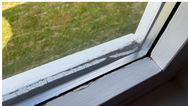
Det er registrert slitasje på vinduer med sprekker i pakning som dels ligger nede og fuktpåkjønning av karm
