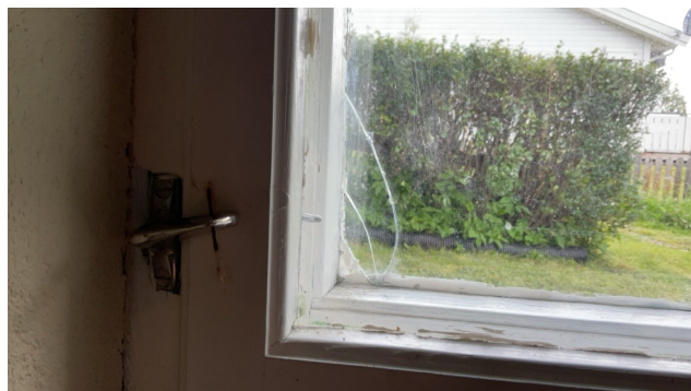
Sprekk i glass
