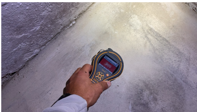
Fuktutslag på gulv på grunn
