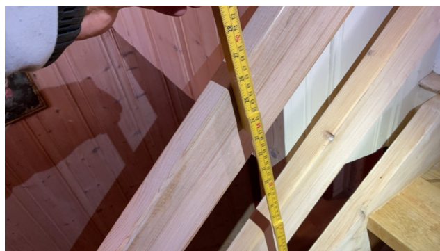
Rekkverkshøyde er under krav
