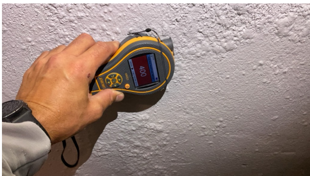
Saltutslag og fuktskjolder på ytermurer
