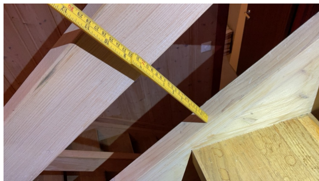
Åpning i rekkverk er over krav
