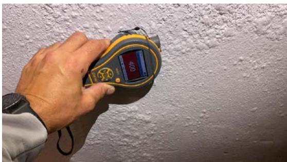
Saltutslag og fuktskjolder på yttermurer
