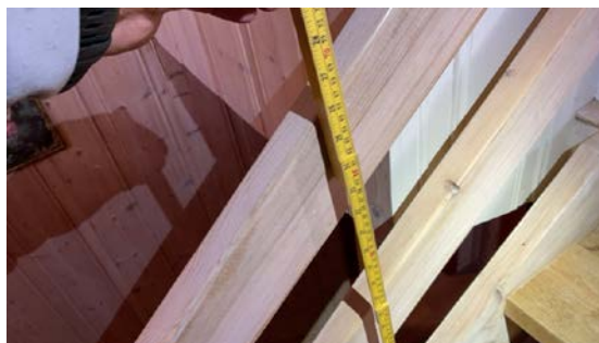
Rekkverkshøyde er under krav
