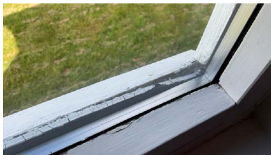
Det er registrert slitasje på vinduer med sprekker i pakning som dels ligger nede og fuktpåkjenning av karm
