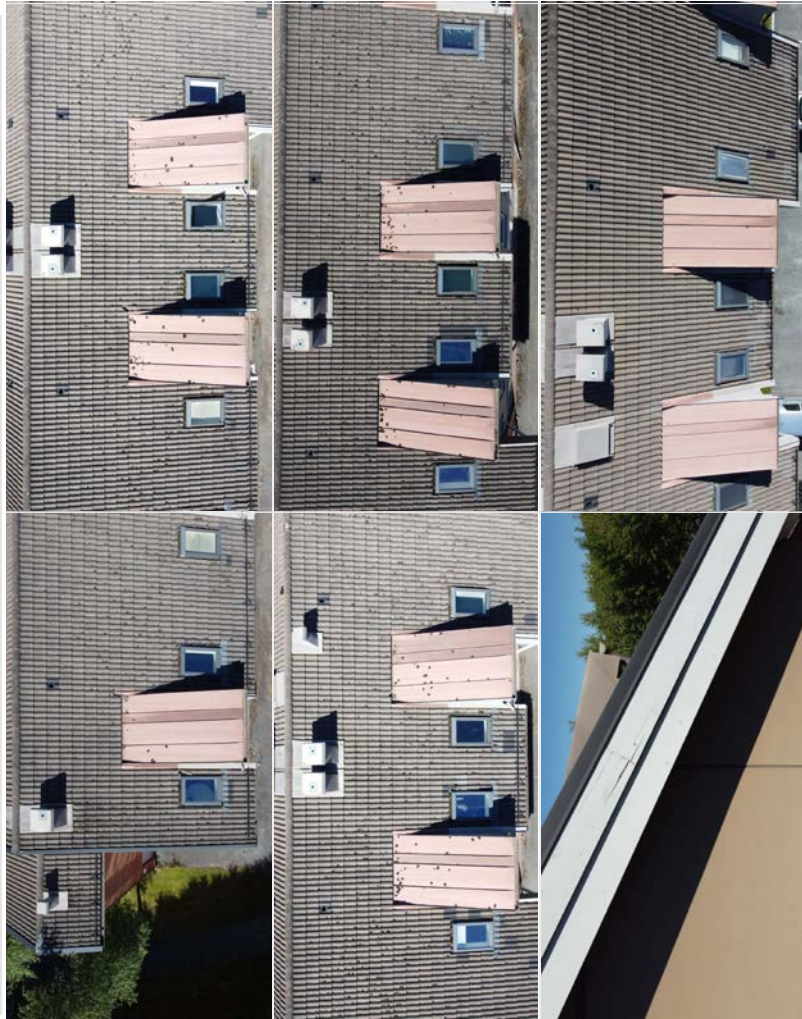
Bilde av knekt takstein og mose på taket, samt tegn til råtne på enkelte vindskjjer.
