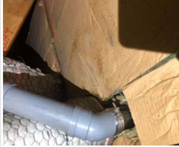
Fuktskjolder på isolasjon. Antatt fra kondens
