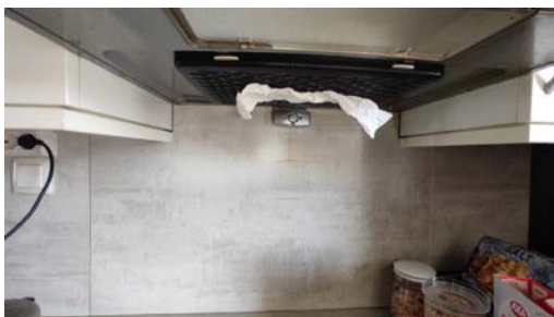
Test av avtrekket.
