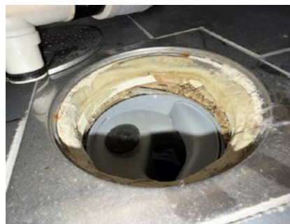
Sluk under dusjkabinett
