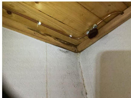
Fuktmerker ved pipe som stammer fra tidligere forhold.
