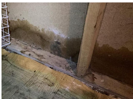
Fuktpåkjenninger på delevegg av tre.
