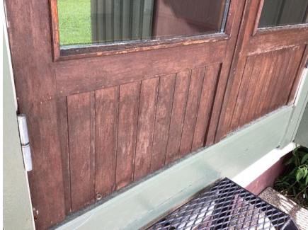
Slitasje på to-fløyet dør.
