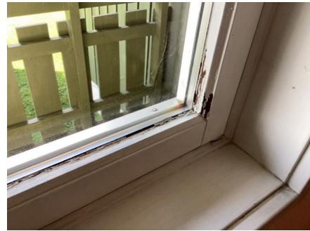
Eksempel på innvendig slitasje.
