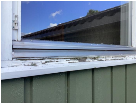
Eksempel på utvendig slitasje.
