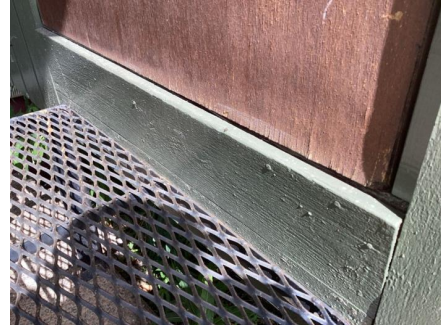
Begynnende skader på boddør.
