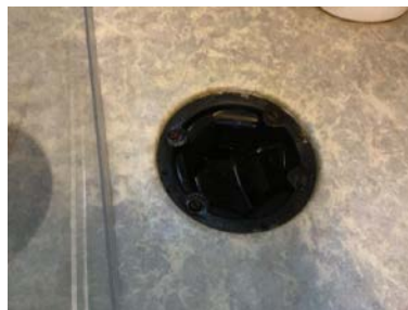
Sluk av plast med klemring i tilslutning til gulvbelegg.
