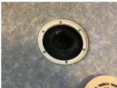
Sluk av plast med klemring i tilslutning til gulvbelegg.
