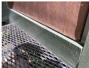
Begynnende skader på boddør.
