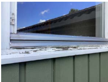
Eksempel på utvendig slitasje.
