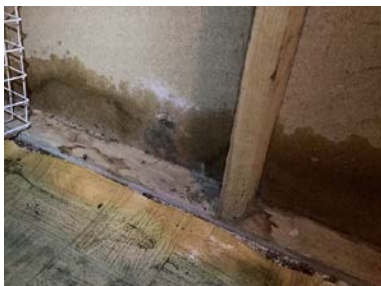
Fuktpåkjenninger på delevegg av tre.
