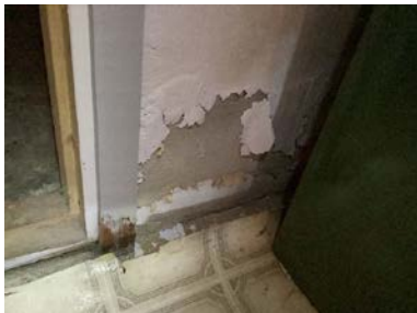
Avskaling av maling etter kapillært fuktopptrekk i mur.
