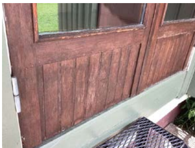
Slitasje på to-fløyet dør.
