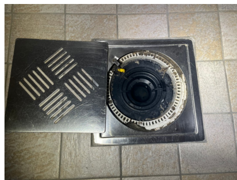
Sluk i dusjsone.
