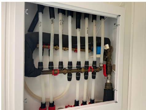
Fordeleskap for vann med stoppekran.
