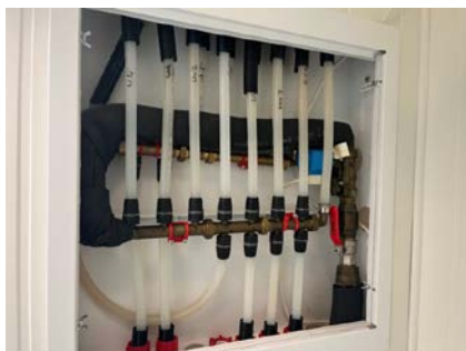
Fordelerskap for vann med stoppekran.
