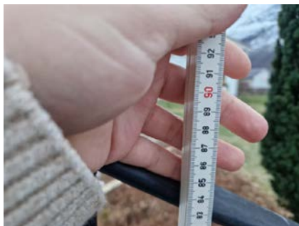
Rekkverk er målt til ca 84cm.
