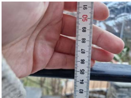
Rekkverk er målt til ca.85 cm.
