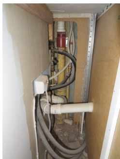
Stoppekran bak kjøkkeninnredning.
