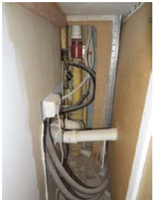
Stoppekran bak kjøkkeninnredning.
