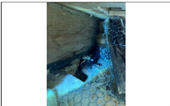
Misfarging og råte i nedre kant av bjelker.
