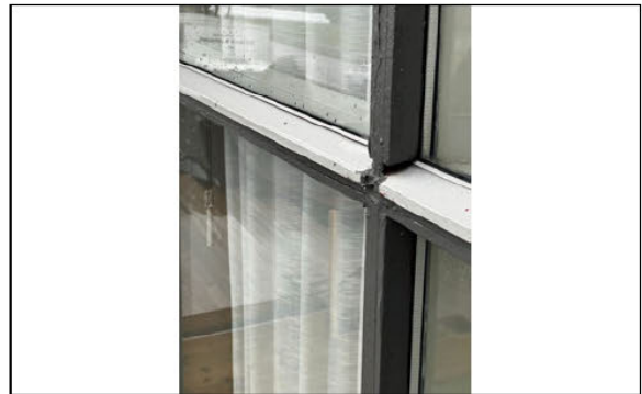
Det er betydelig fuging i mellom vindusramme og glass på vindusfelt i stuen.
