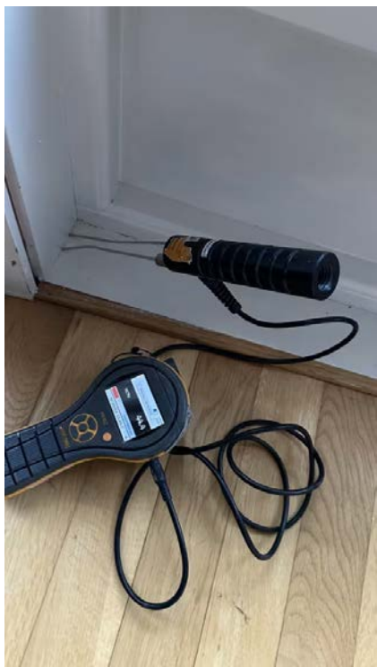
1.etasje - Balkongdør Høyere fuktverdier
