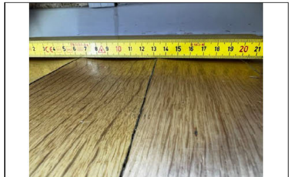
Kuving i gulv grunnet fukt.
