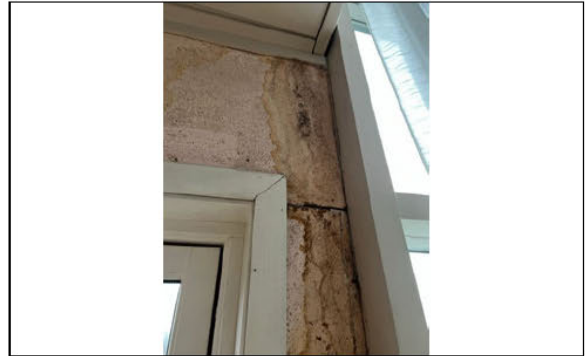
Skjolder og fuktskader i vegg, her i overkant av terrassedør.
