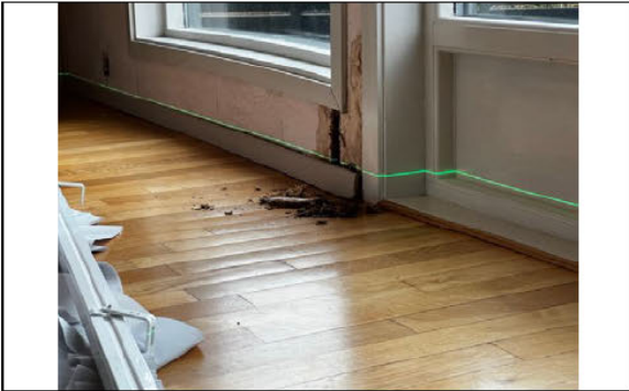
Det er fuktskader i yttervegg ved vinduer og terrassedør i stuen.
