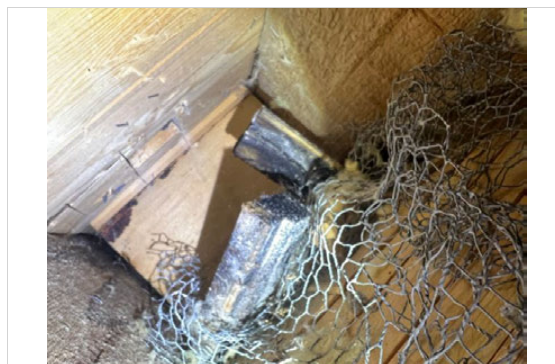
Råte i spikerslag mellom bjelkene mot grunnmur.
