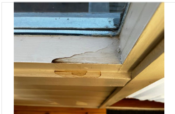
Skjolder etter vanninntrenging i selve vindusfeltet.
