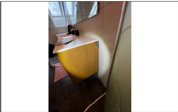
Fuktskade på seksjon etter vann.
