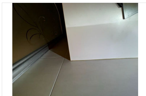
Vannet rennet ut i silikonfugen under bruk og gir opptukning/fuktskader i selve seksjonen.
