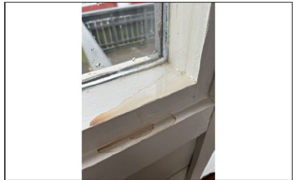
Foto tatt av eier, og viser fukt i vinduskarm i felt over entre.
