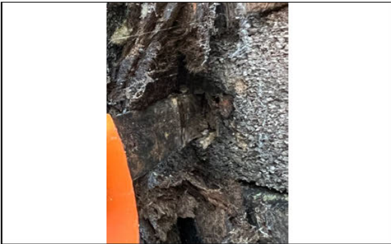
Råte i bjelker, kontrollert fra utsiden.
