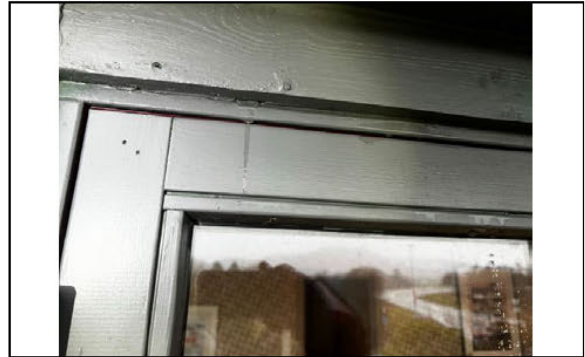
Man ser her vann som kommer ut på baksiden av belistningen over terrassedøren. Årsaken er inndrev bak kledning/belistning på oversiden av balkong.
