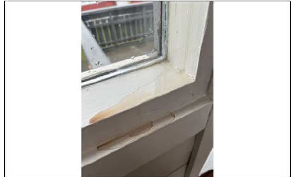
Foto tatt av eier, og viser fukt i vinduskarm i felt over entre.
