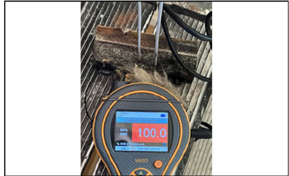
Fuktmåling i råteskadet trevirke som ble tatt ut fra etasjeskillet.
