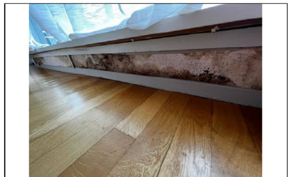
Skjolder, samt soppvekster, på innvendig overflate som følge av fukt/vanninntrengninger.
