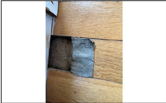
Fjernet noe parkett for kontroll av undergulv i stuen. Skade/skjolder etter fukt i ullpapp mellom undergulv og heltre parkett.
