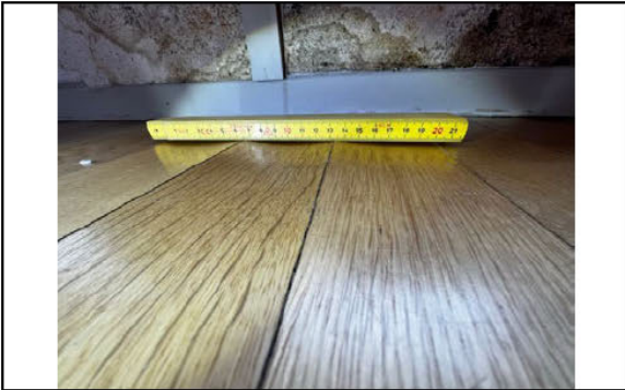
Kuving i gulvet grunnet fukt.
