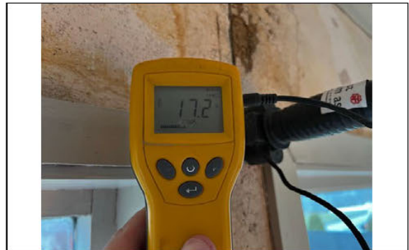
Fuktmåling i yttervegg i øvre del over vindu/dør under balkong.
