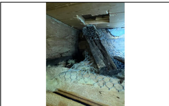
Råte i spikerslag/bjelker ut mot yttervegg.
