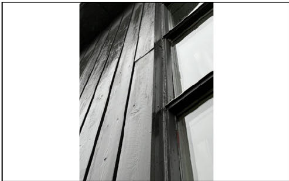
Fuging mellom vindu og belistning.
