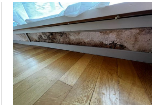
Mugg/soppvekster på vegg under vindu til høyre samt fukt.
