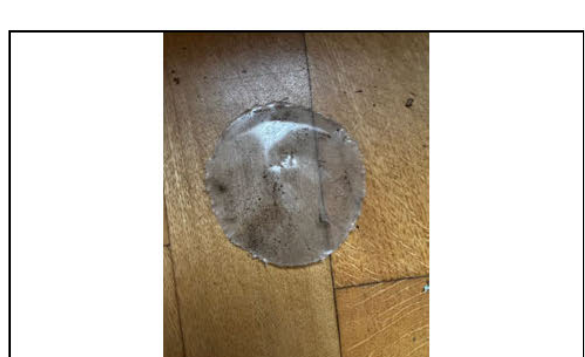
Muggvekster på selve plastfolien som ligger mellom isolasjon og veggplate innvendig.
