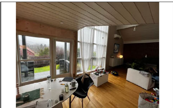
Stue, foto viser vindusvegg som har fuktskader under og rundt vinduer/terrassedør.
