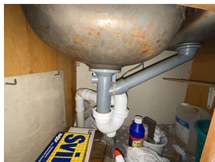
Del av rør til avløp.
