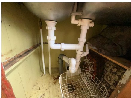
Del av rør til avløp.
