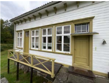
Hovedinngangsdør. Dør til venstre er ikke bruk.
