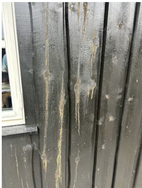
Viser utslag av kvæ i utvendig kledning.
