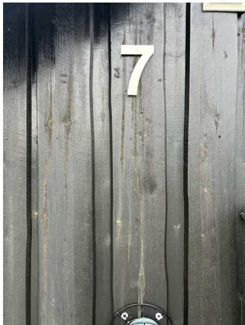
Viser utslag av kvæ i utvendig kledning.
