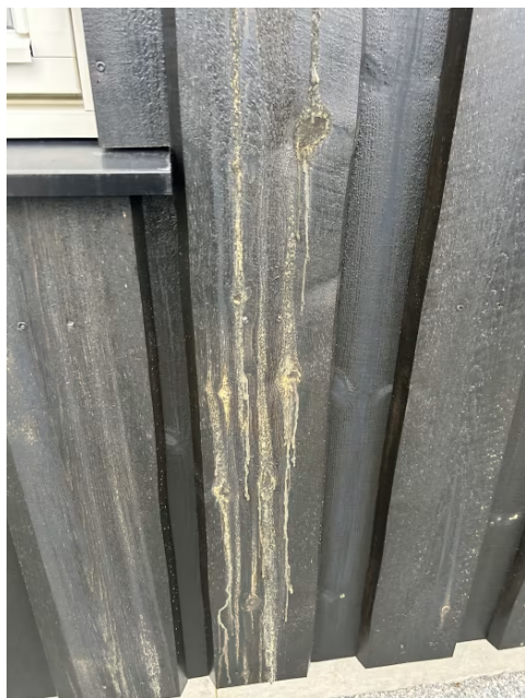
Viser utslag av kvæ i utvendig kledning.
