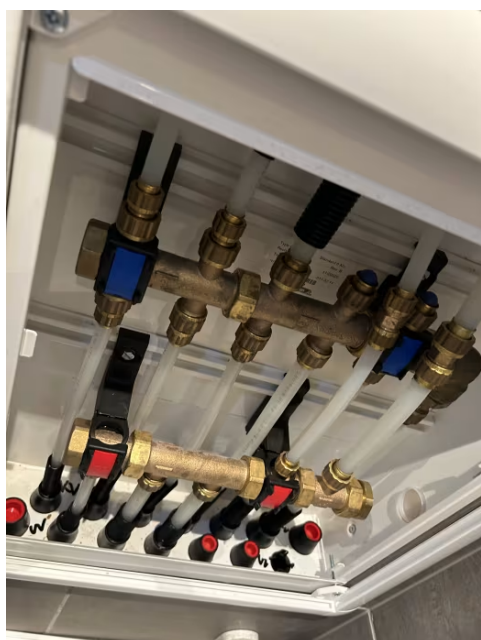
Fordelerskap til vann.
