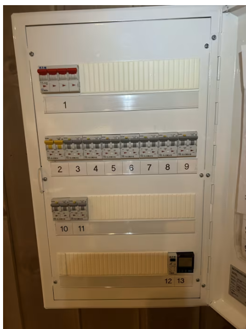
Sikringsskap plassert i gang.
