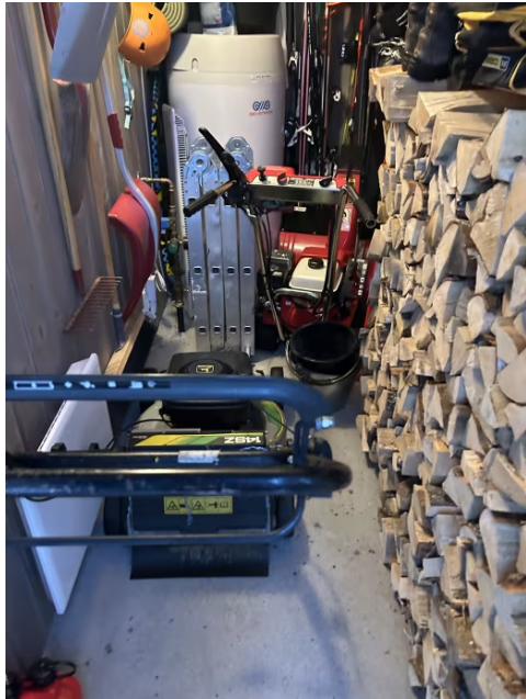
Varmtvannsbereder plassert i utvendig bod.
