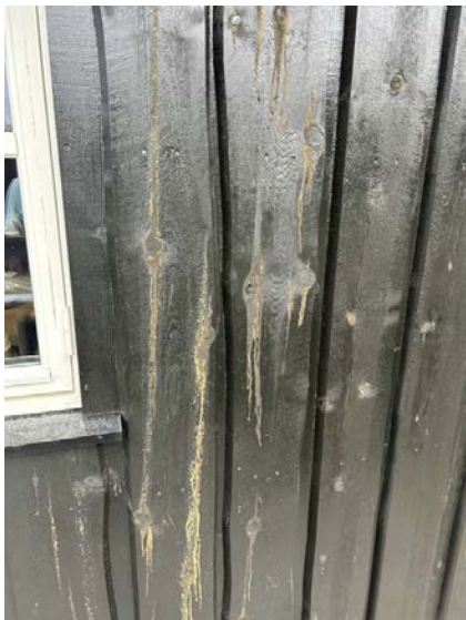
Viser utslag av kvæ i utvendig kledning.
