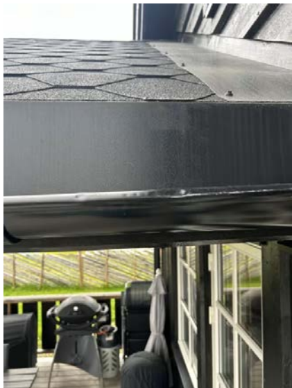
Skade på takrenne på overbygg til terrasse.
