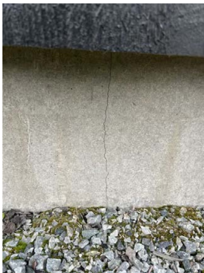
Sprekk i plate utenpå ringmur.
