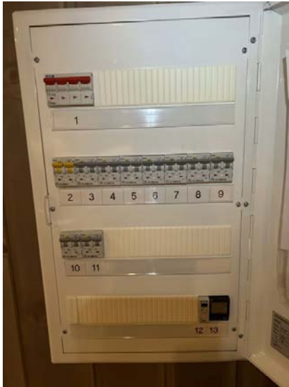
Sikringsskap plassert i gang.
