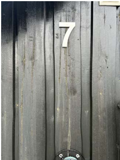
Viser utslag av kvæ i utvendig kledning.
