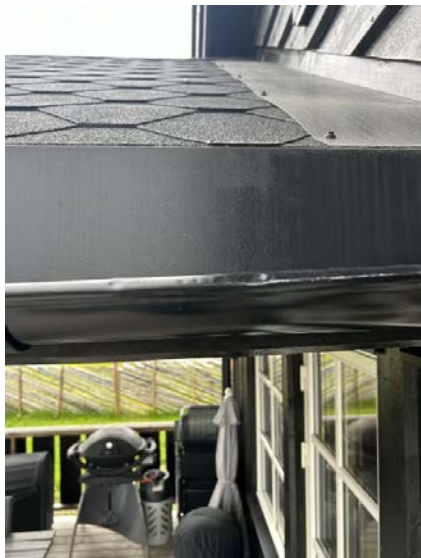
Skade på takrenne på overbygg til terrasse.
