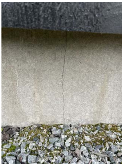
Sprekk i plate utenpå ringmur.
