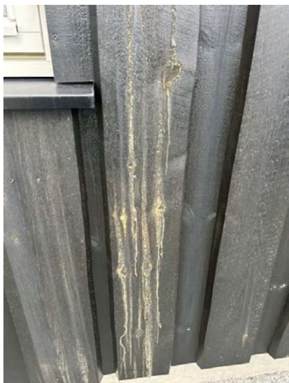
Viser utslag av kvae i utvendig kledning.
