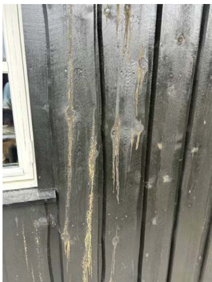
Viser utslag av kvæ i utvendig kledning.
