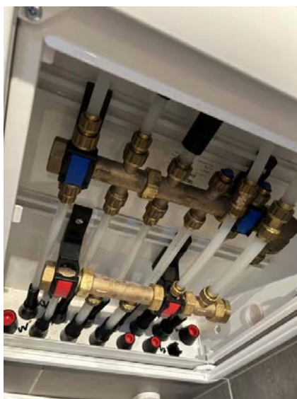
Fordelerskap til vann.
