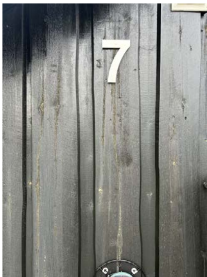
Viser utslag av kvæ i utvendig kledning.
