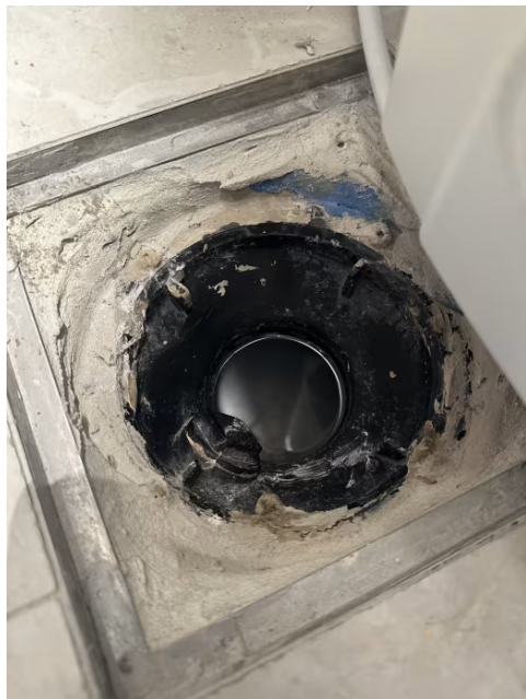
Sluk i vaskerommet.
