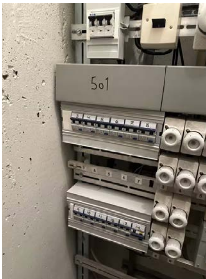
Sikringsskap er plassert i felles areal. Kursfortegnelse er på vegg i en mappe.
