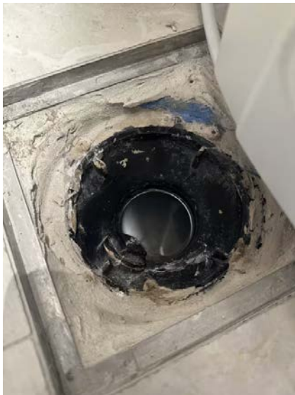
Sluk i vaskerommet.
