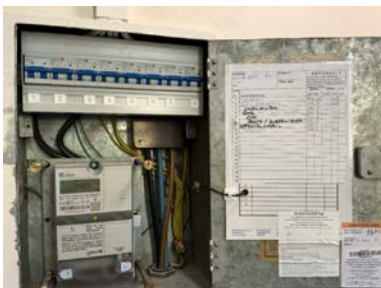
Jordfeilbrytere i sikringsskap plassert i gang/fellesareal
