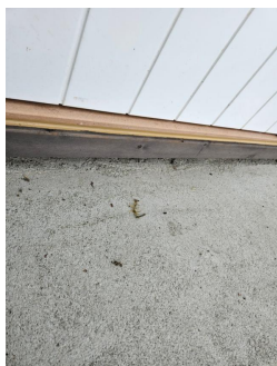
Kun fuget mellom dørterskel og vegg.
