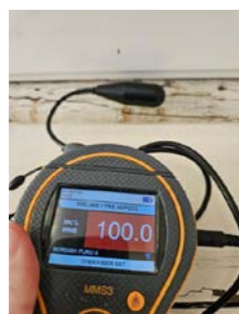
Fibermetning + fritt vann tyder på at stokken fremdeles tilføres vann.
