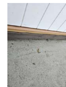
Kun fuget mellom dørterskel og vegg.
