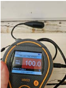
Fibernetning + fritt vann tyder på at stokken fremdeles tilføres vann.
