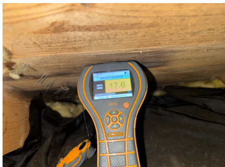
Fuktig trevirke ned mot raft inn mot balkong fra stue.
