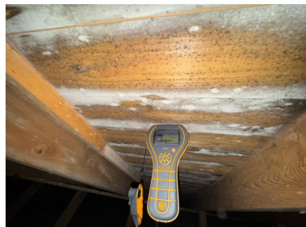
Fuktig trevirke med soppvekst over garasje.
