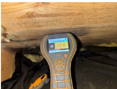
Fuktig trevirke ned mot raft inn mot balkong fra stue.
