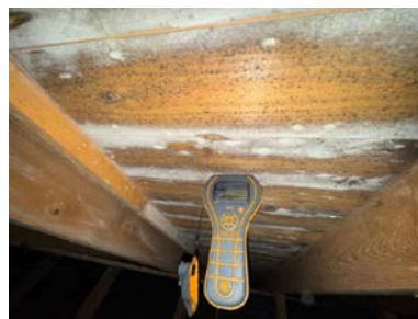
Fuktig trevirke med soppvekst over garasje.
