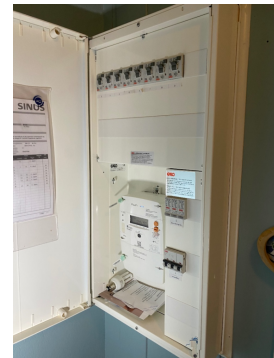
Sikringsskap med automatsikringer, plassert i gangen.
