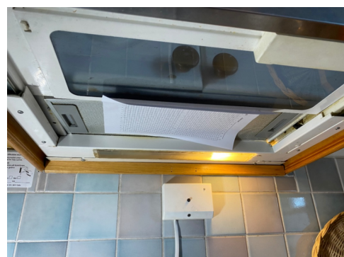
Funksjonstest av ventilator.
