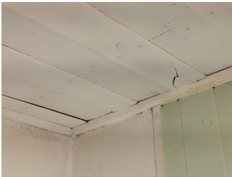
Tak i trappeoppgang til 2. Etg.
