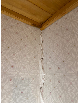
Tapet, hjørne på soverom i 2 etg.
