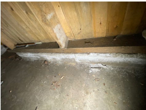
Saltutslag i kjeller, bod under trapp.
