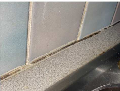
Svertesopp i fuge mellom benkeplate og vegg.
