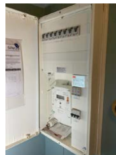
Sikringskap med automatsikringer, plassert i gangen.
