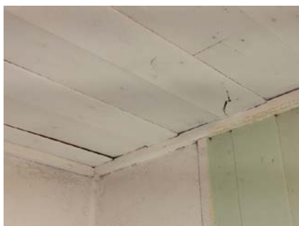
Tak i trappeoppgang til 2. Etg.
