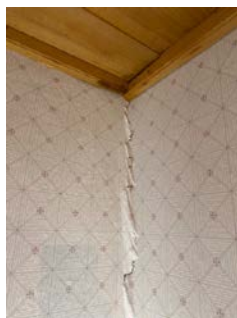
Tapet, hjørne på soverom i 2 etg.
