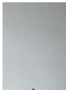
Det er registrert mindre riss i pipen i stue.
