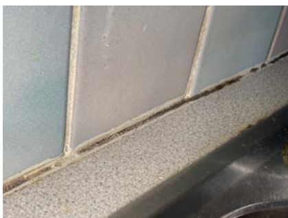
Svertesopp i fuge mellom benkeplate og vegg.
