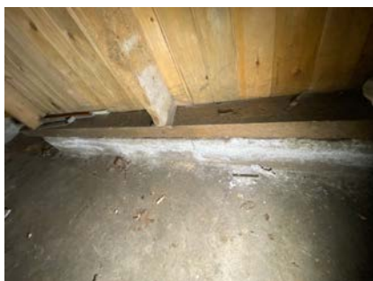
Saltutslag i kjeller, bod under trapp.
