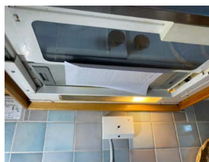
Funksjonstest av ventilator.
