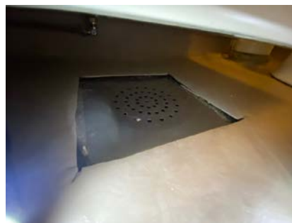
Utett belegg rundt gulvsluk.
