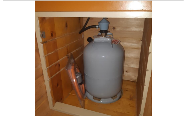
Gassflaske i kjøkkenbenk
