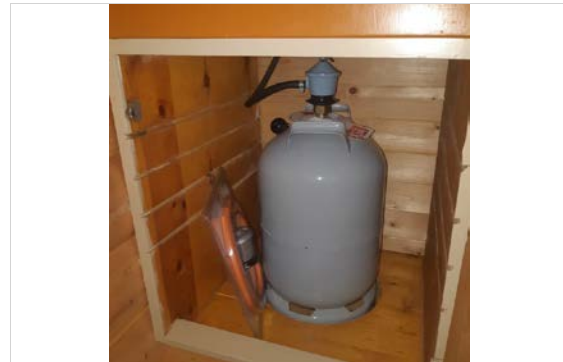
Gassflaske i kjøkkenbenk
