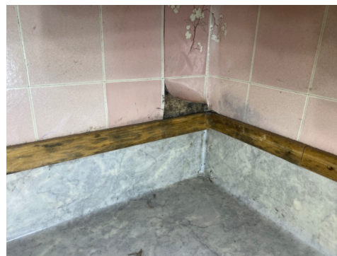
Svertesopp mot list/veggplater.
