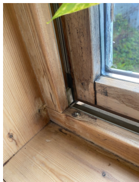
Tegn til svertesopp, vindu på kjøkken.
