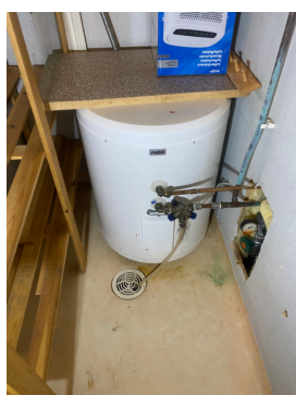
VVS bereder plassert på boden.
