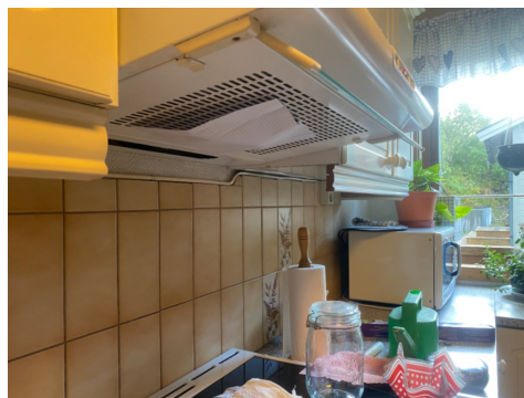
Funksjonstest av ventilator.
