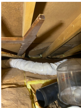
Fuktskjolder/svertesopp mot raft
