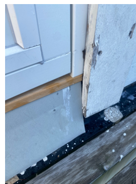
Glippe mellom beslag/dekkobord.
