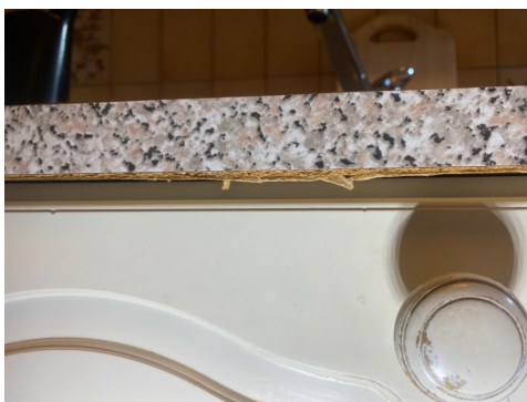
Fuktsvellinger i benkeplate
