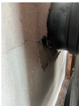
Riss i pipe samt manglende murpuss/tetting rundt røykrør
