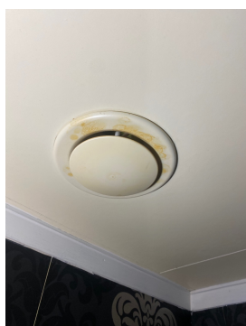
Tegn til kondens/fuktmerker på ventil i tak.
