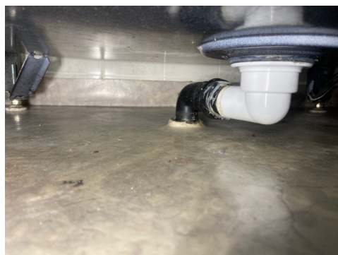
Avløp fra kabinett.
