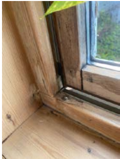
Tegn til svertesopp, vindu på kjøkken.
