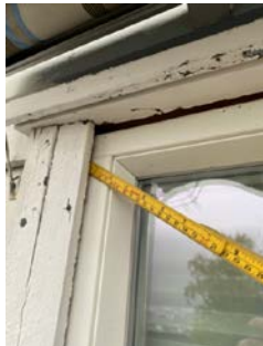
Glipper/åpninger mellom dekkbord og karm.
