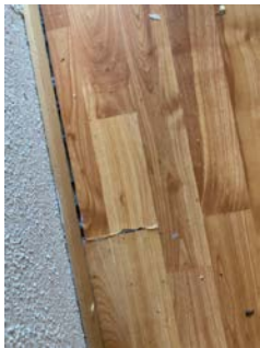
Skade/svelling i laminatgulv, stue.
