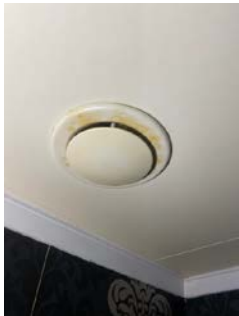
Tegn til kondens/fuktmerker på ventil i tak.
