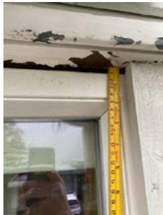
Glipper/åpninger mellom dekkbord og karm.
