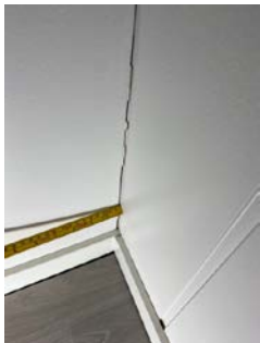
Sprekk i hjørne vegg, glippe mellom laminat og gulvlist
