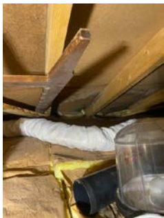
Fuktskjolder/svertesopp mot raft
