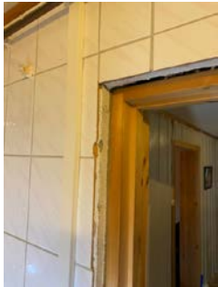
Det er påvist rust i armeringen over døren.
