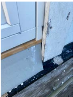
Glippe mellom beslag/dekkobord.
