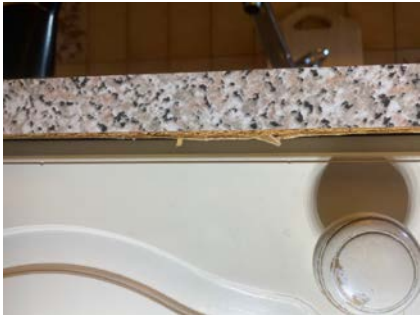
Fuktsvellinger i benkeplate
