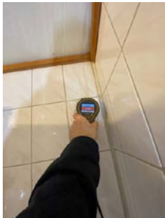
Fuktmåling av overflater viser forhøyde fuktverdier.
