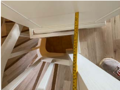
Åpninger i rekkverk.
