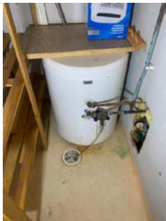
VVS bereder plassert på boden.
