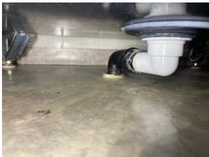
Avløp fra kabinett.
