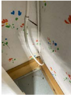
Svertesopp mot hjørne, soverom i kjeller.
