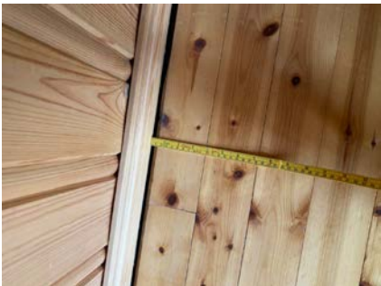
Glippe mellom gulv/vegg.
