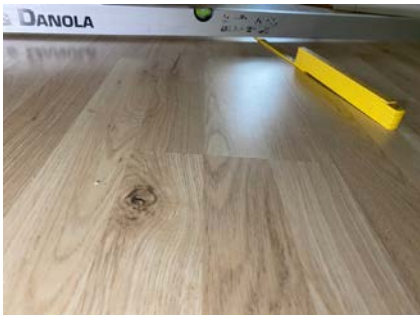
Synlig skjevhet i gulvet for gangen i hovedetasjen
