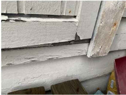
Balkongdør mot vest, manglende beslag.
