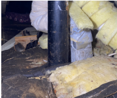
Det er påvist ventilasjonskanaler i asbest.
