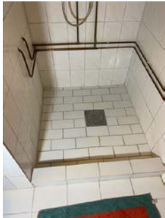
Dusjnisje, Det er registrert hulrom under fliser.
