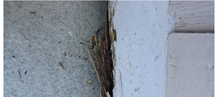
Kledning og bunnstokk med råte
