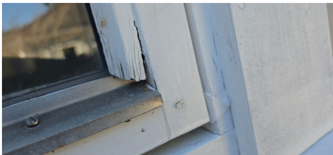
Sprekker i karmen gamle vinduer.
