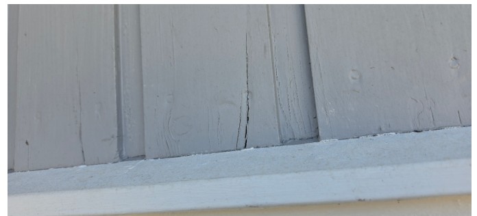
Kledning over vinduer, sprekker
