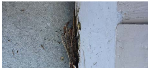
Kledning og bunnstokk med råte
