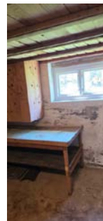
Synlig salt utslag og fukt merker vegg/gulv høye fukt indikasjoner registret.
