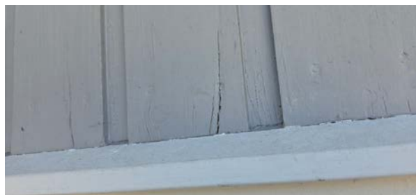
Kledning over vinduer, sprekker
