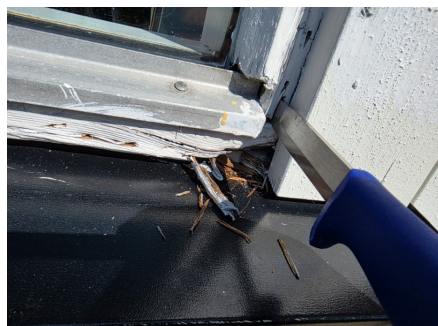
Råteskade på stort vindu i stue/spisestue
