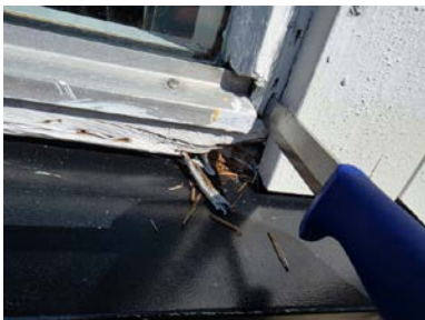
Råteskade på stort vindu i stue/spisestue
