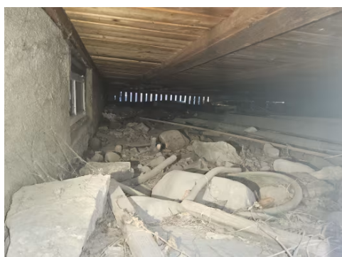
Det kan ikke verifiseres at det er etablert utvendig fuktsikring på grunnmuren mot tilbygget del.
