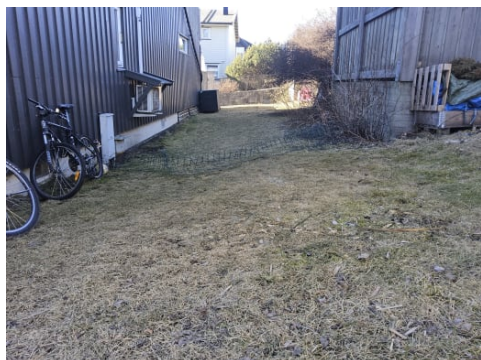
Terreng har stedvis fall mot grunnmuren.
