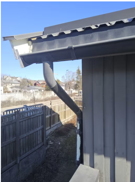
Takrenner og nedløp bærer preg av alder.
