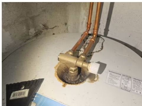
Det registreres tegn til en gammel lekkasje på varmtvannsberederen.
