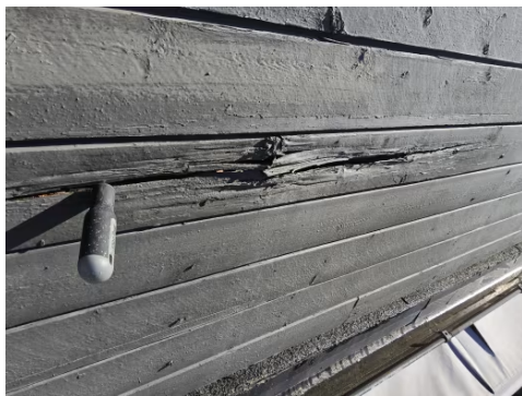
Det registreres råteskader i rekkverk.
