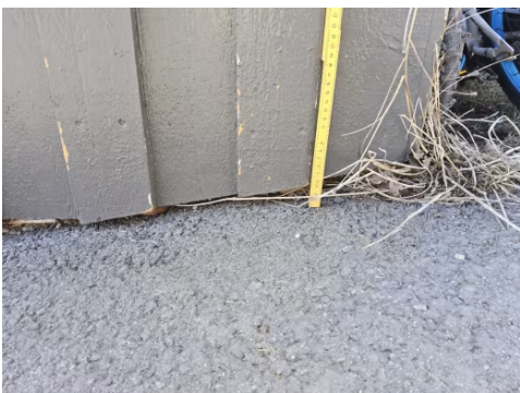
Deler av kledningen er avsluttet nærme terreng.
