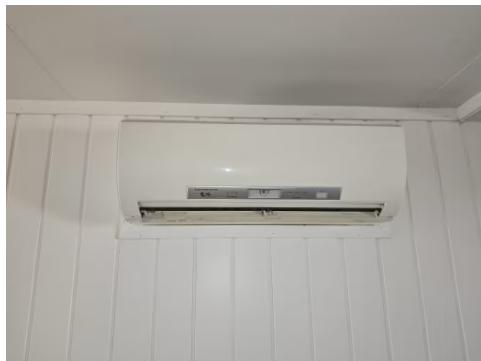
Varmepumpe er plassert i stue.
