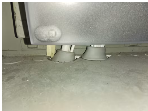
Det registreres utettheter ved gjennomføringer i sikringsskapet.
