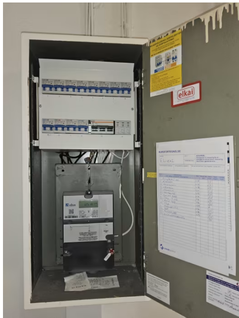
Sikringsskap er plassert i gang i andre etasje.
