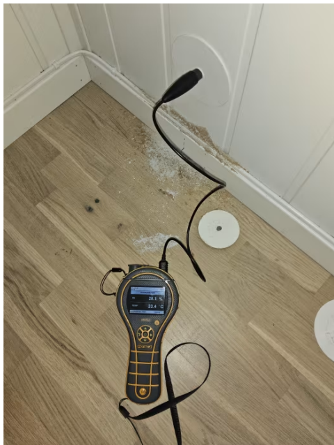
Bilde fra fuktmåling i vegg tilstøtende dusjsone.
