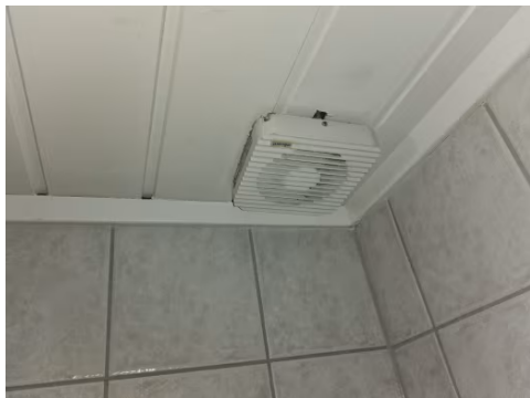
Avtrekksvifte er montert i himlingen.
