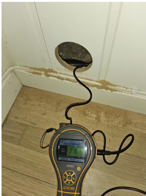
Bilde fra fuktmåling i utlektet kjellervegg.
