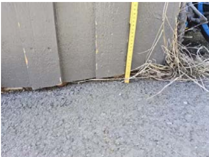
Deler av kledningen er avsluttet nærme terreng.
