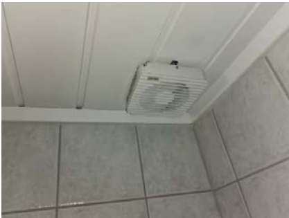
Avtrekksvifte er montert i himlingen.
