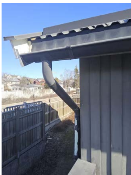
Takrenner og nedløp bærer preg av alder.
