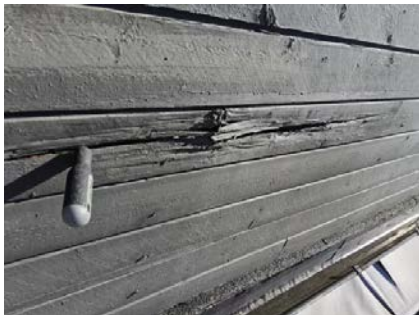
Det registreres råteskader i rekkverk.
