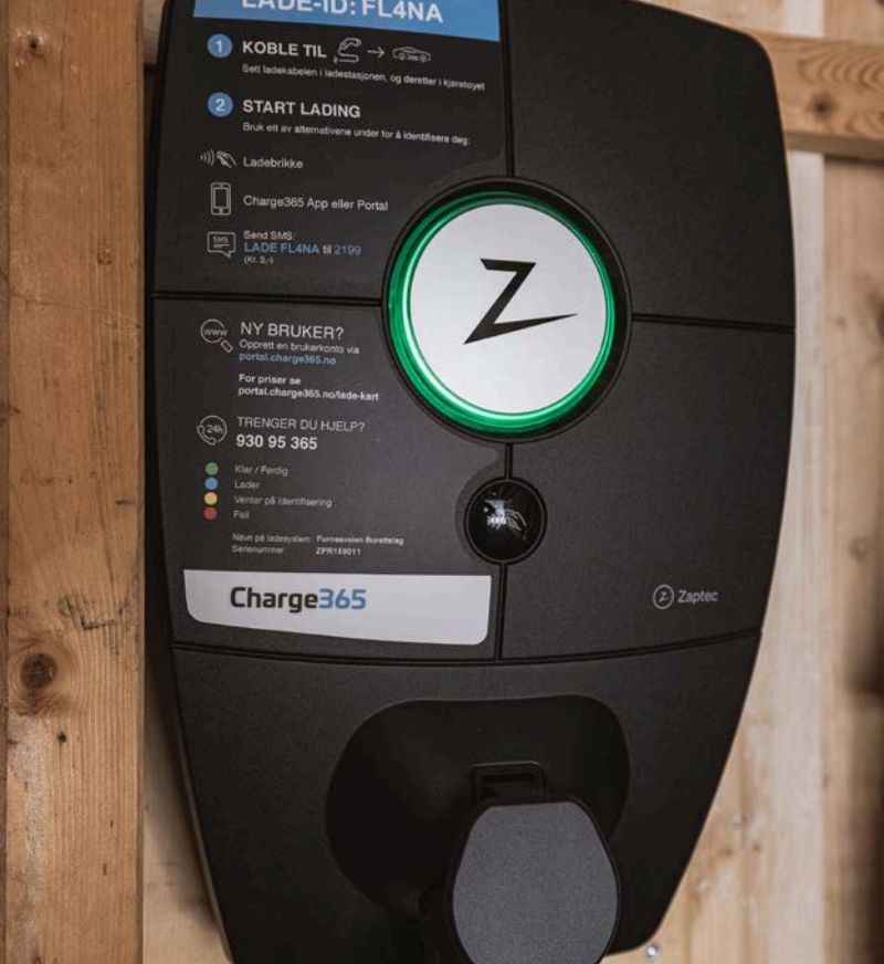
Det er montert elbil-lader.
