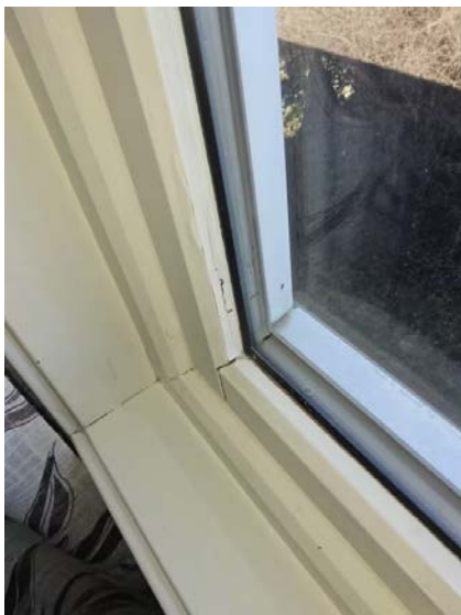
Det registreres oppsprukket maling på innsiden av enkelte vinduer.
