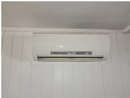
Varmepumpe er plassert i stue.
