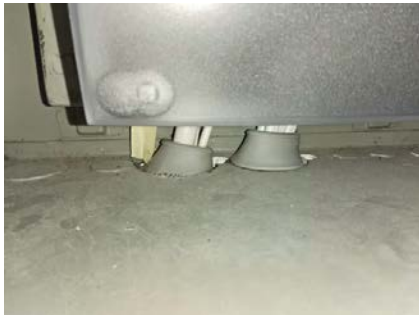
Det registreres utettheter ved gjennomføringer i sikringsskapet.
