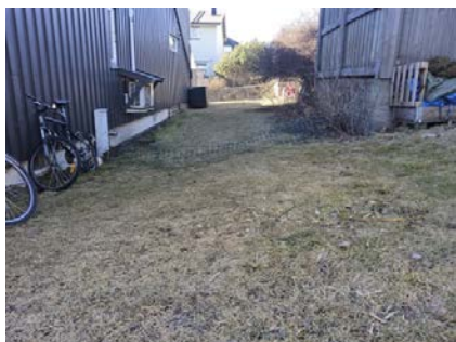
Terreng har stedvis fall mot grunnmuren.
