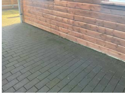
Ikke tilstrekkelig avstand under kledning.
