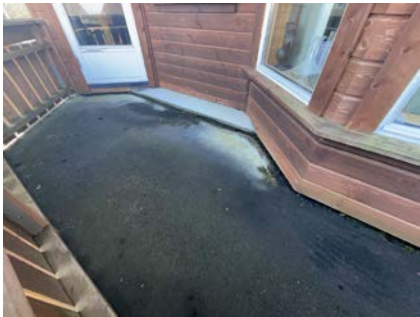
Ikke tilstrekkelig avstand under kledning.
