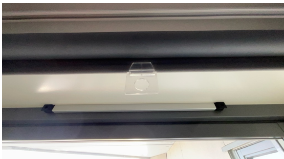
Eksempel på montert ventil i vindu.
