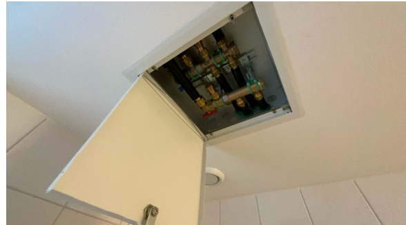
Skap til rør i rør system, her er også stoppekran til vann.
