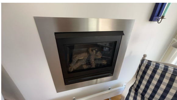
Montert peis med innsats.
