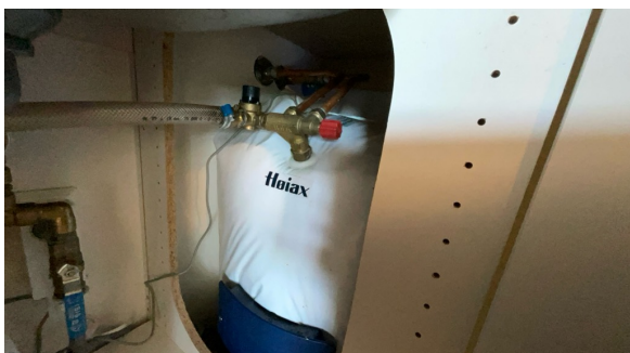
Varmtvannstank i kjøkkenbenk.
