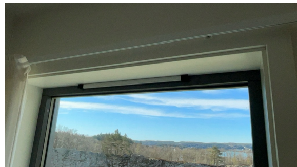
Eksempel på montert ventil i vindu.
