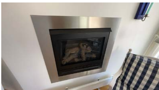
Montert peis med innsats.
