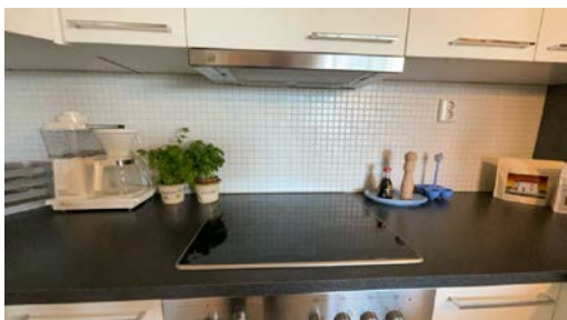
Montert avtrekk over steketopp.
