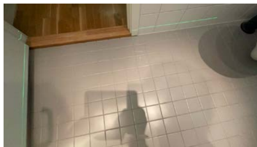
Målt fall på gulv.
