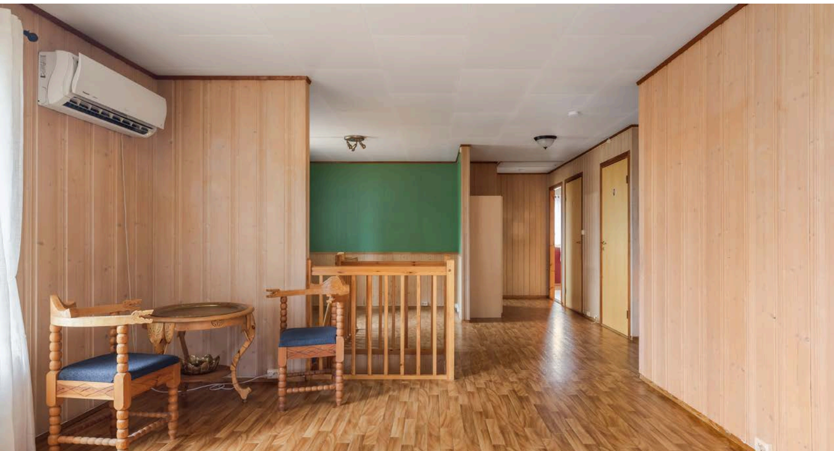
I stua er det montert varmepumpe.
