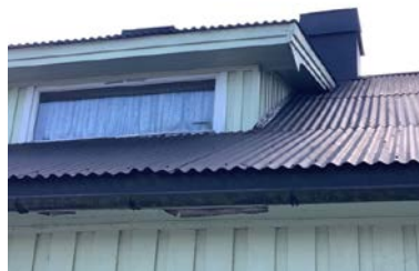
Det er tilsynelatende ikke beslag i overgangen mellom vegg på ark om omkringliggende tak.
