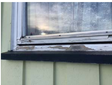
Eksempel på slitasje.
