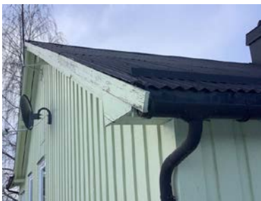
Takplater begynner stedvis og løsne mot ytterkanter.
