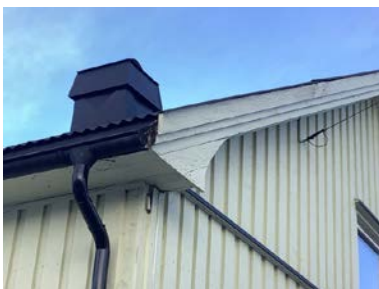
Det er ikke benyttet isbordbeslag på vinds kier.
