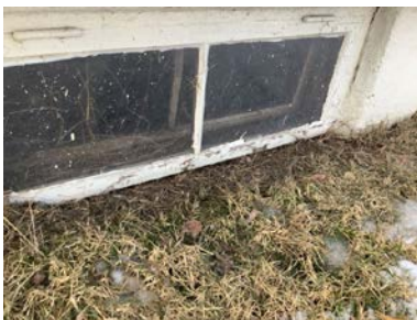
Eksempel på vindu med råteskade.
