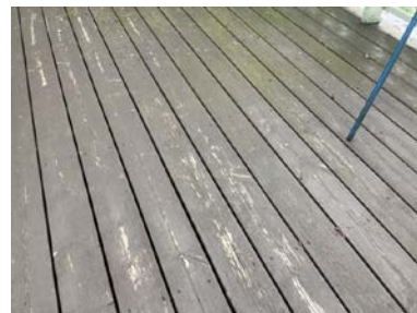
Eksempel på slitasje på overflate.
