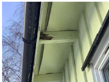
Råteskade i takspærre.
