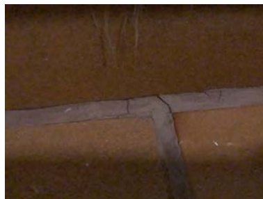
Eksempel på sprekk i fuger i dusjsonen.
