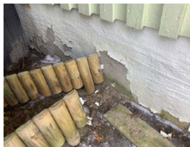
Eksempel på avskaling på grunnmur.
