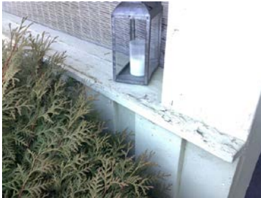
Eksempel på slitasje på rekkverk på veranda ved entre.
