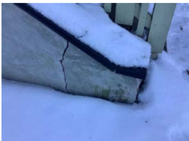
Eksempel på sprekk i støttemur mellom boliger.
