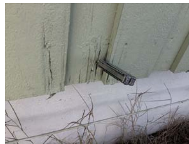
Eksempel på råte i kledningsbord.
