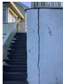
Eksempel på sprekk i støttemur mellom boliger.
