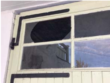
Skadet glass på port.
