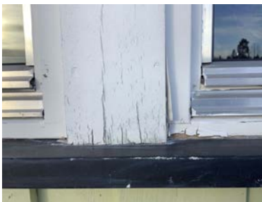
Eksempel på slitasje og oppsprekking på omrammingsbord.
