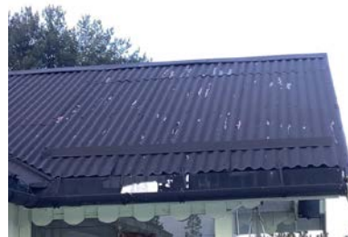
Stedvis avskalinger på overflater.
