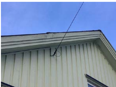
Det er slitasje og mulig råte på vinds kier.
