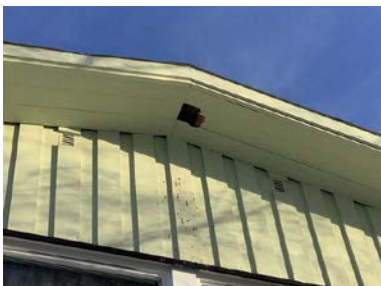
Skade i gesimskledning.
