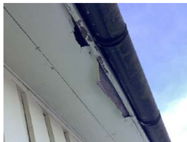
Slitasje og råte på kledning i gesims.
