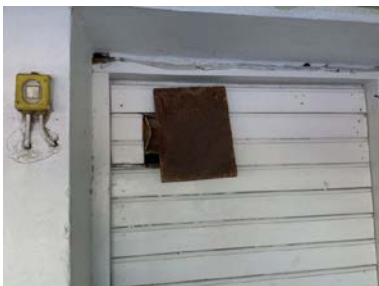
Det er åpning med provisorisk tetting på kjellerdør.
