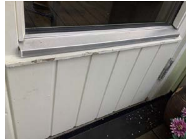
Eksempel på slitasje på verandadør.
