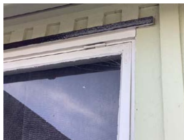
Skade på glass i bod.
