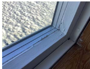
Eksempel på innvendig slitasje.
