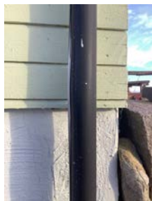
Eksempel på frostspreng på taknedløp.
