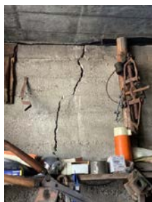
Eksempel på sprekke i grunnmur.
