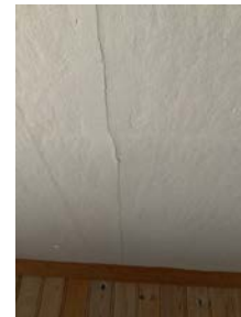
Eksempel på sprekk på slett overflate.
