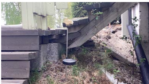
Skade på trappevange på trapp ved eldste bolig.
