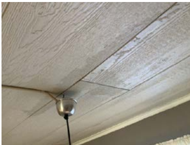
Fuktskade i himling på kjøkken.
