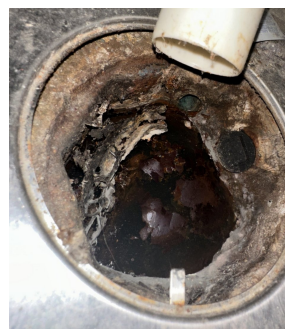
Originalt sluk med rustdannelse
