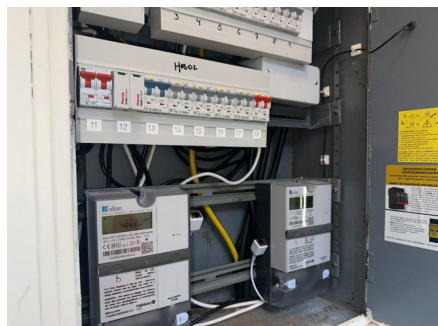
Sikringsskap med automatsikringer.
