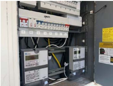
Sikringsskap med automatsikringer.
