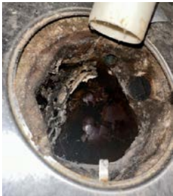
Originalt sluk med rustdannelse
