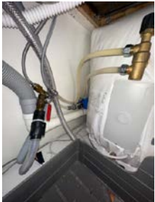
Røropplegg i kjøkkenbenk med Waterguard
